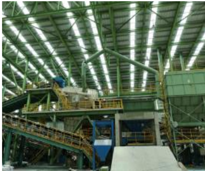
圖 3-3 電弧爐煉鋼還原渣(石)破碎、磁選、篩分、安定化與集塵生產線設備
